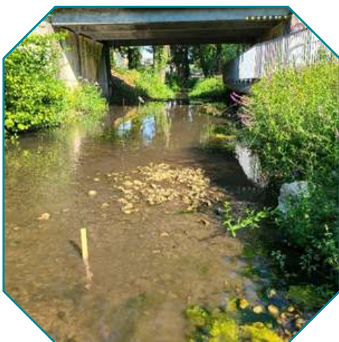
Etat avant travaux
